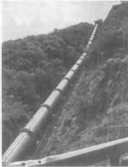
Imagen 15.13. Conducto de aguas negras de la Central Hidroeléctrica Valentín Gómez Farías. Autor: Luis Castillo.
